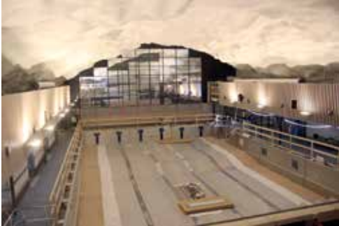
Pääaltaasta puuttui vielä vähän muutakin kuin vesi.
